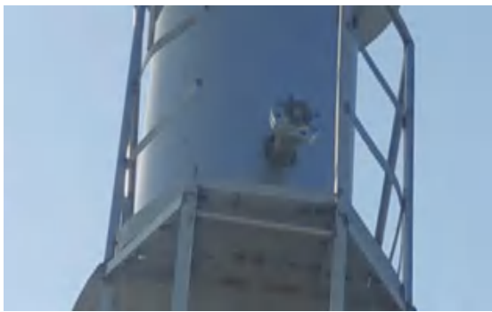
排气筒取样口
