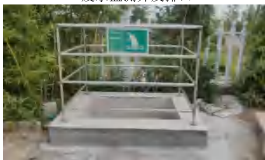
雨水、清下水排口
