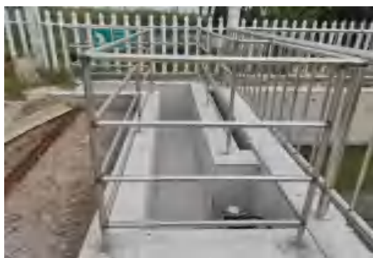
废水监测井及排口
