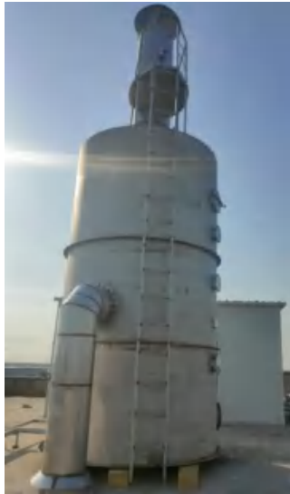
TA001 旋风+水膜除尘器
