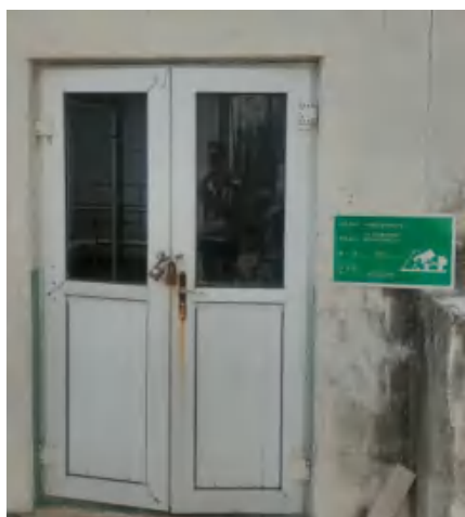
一般固废暂存间外部+环保标识牌
